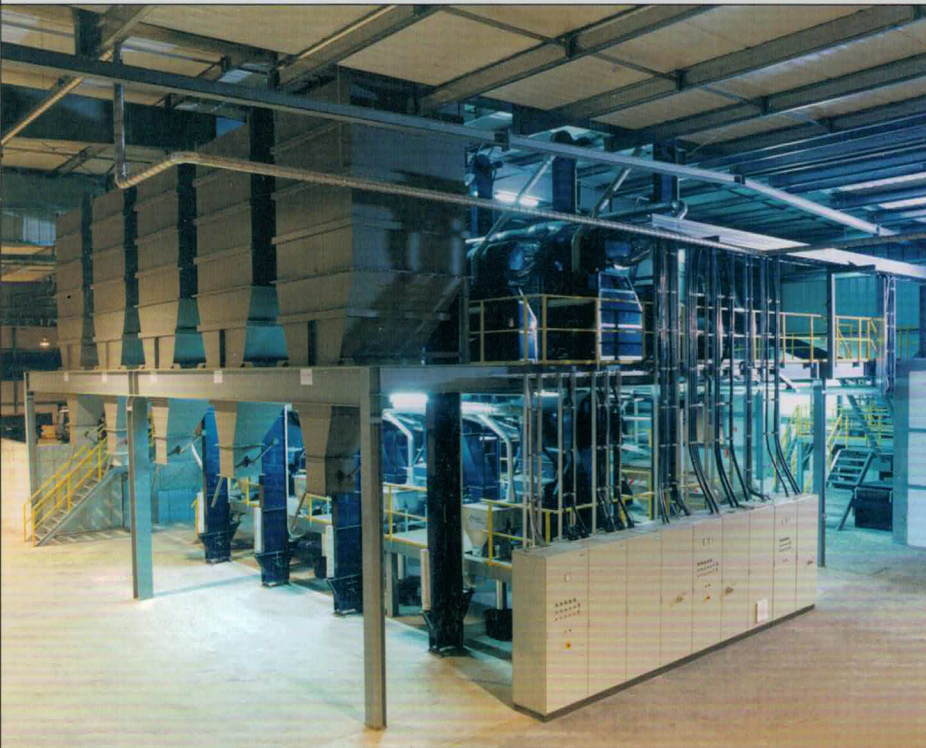
Sieb- und Reinigungsanlage Vier Reinigungsstraßen mit Textil- und Schwerteilausleser garantieren höchste Qualität.
